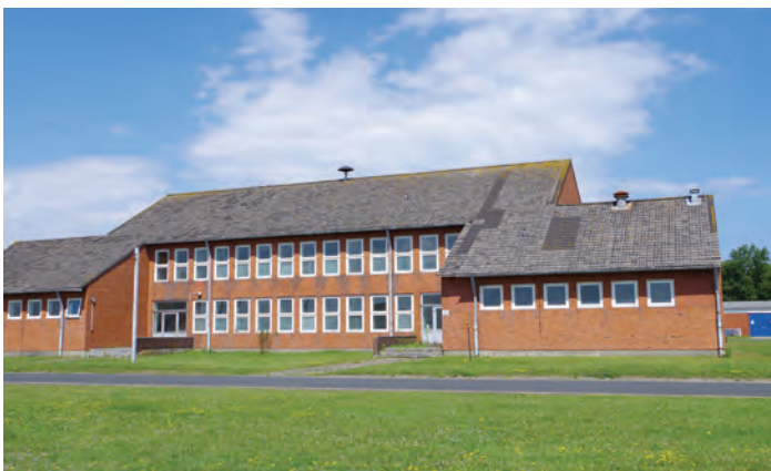
Abb. 20 Leerstand und hoher Sanierungsbedarf an der Westkaje
