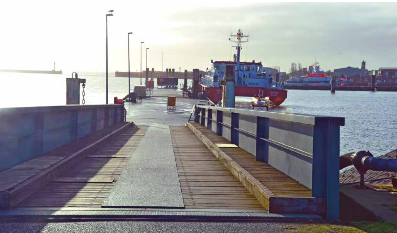
Moderne Schwimmpontons bieten die benötigte Ausstattung.
